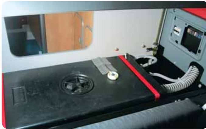
Versteckt, aber zentral: Im Küchenblock unter der Bettverlängerung machen sich Frischwassertank, Aufbauabatterie und die Sicherungen breit.
